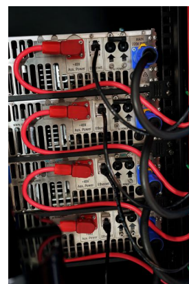
CONEXIÓN DC BLADES
